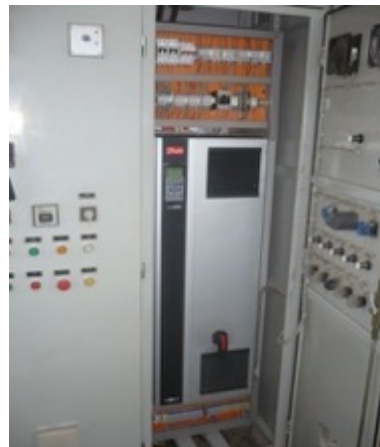
Conversor de Frequência
