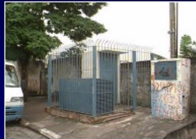
Instalações do booster Munhoz Junior no passeio, RMSP
