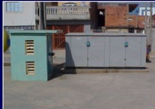
Instalações do booster Vitópolis com inversor de frequência, RMSP
