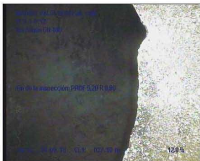
Foto: 12_12_45_A.JPG, VCR No: AVISO 27,1m, Fin de la inspección
