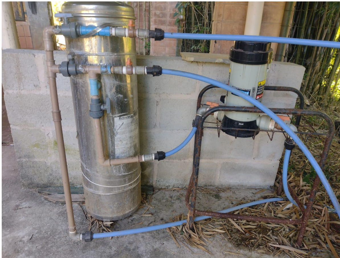
Filtro central e clorador instalados na Fazenda Lambari.
