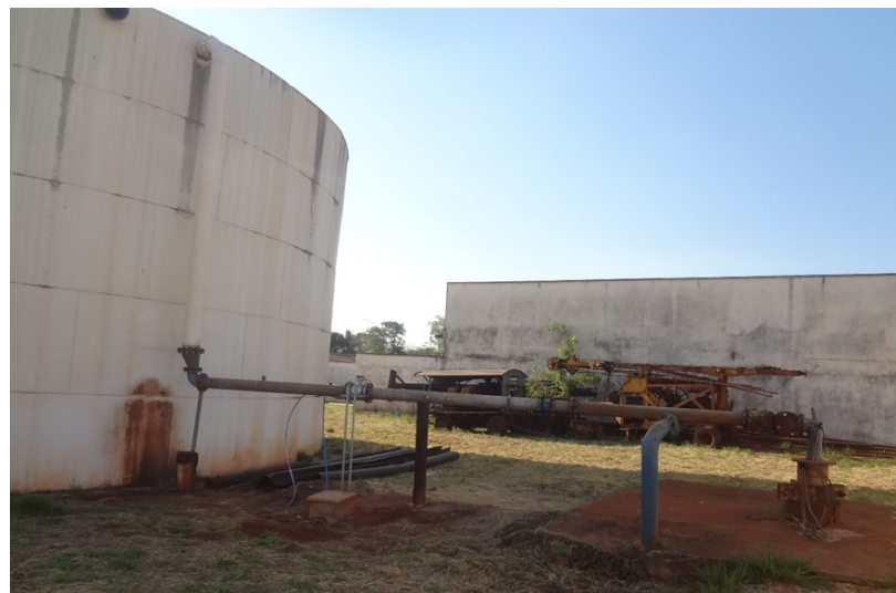
Vista externa: pontos de oxidação
