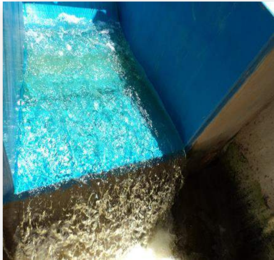
Efluente Tratado 99,7% de remoção de DBO
