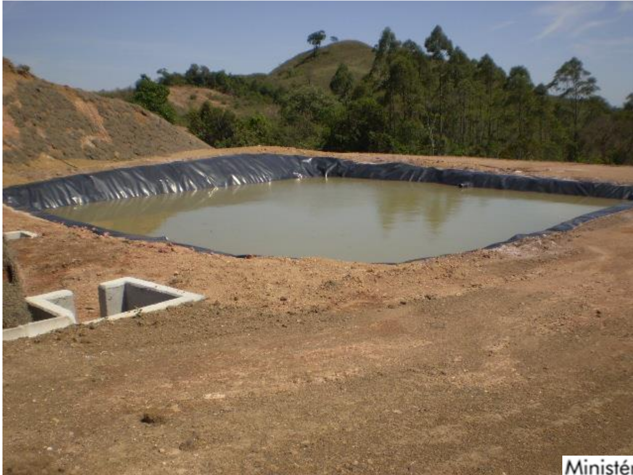
Tratamento - Lagoa anaeróbia
