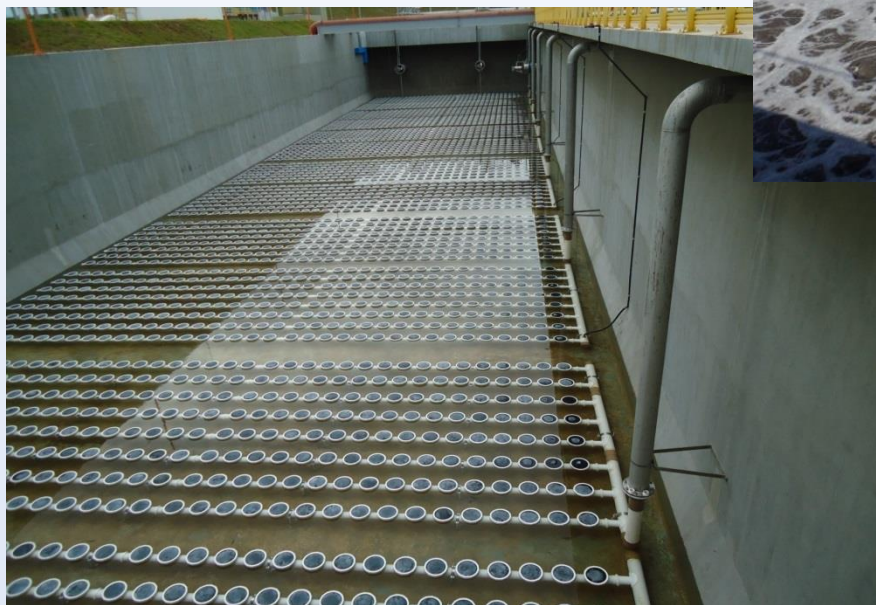
Sistema de aeração bolhas finas - 3.456 difusores
