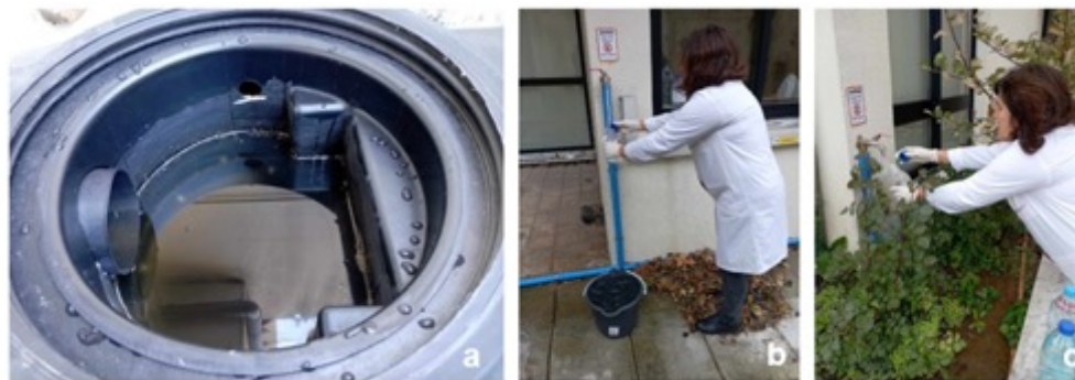
Recolha de água da chuva: Reservatório (a); torneiras (b, c)
