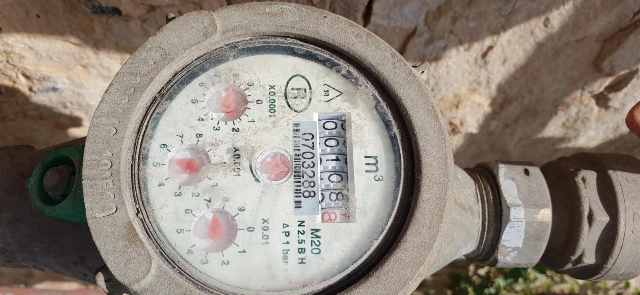
medição no hidrômetro
