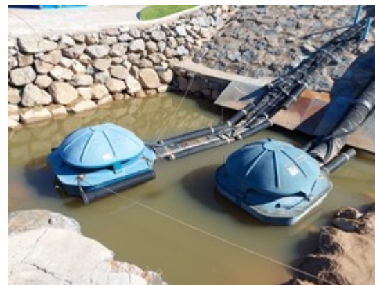
Conjunto de Flutuantes
