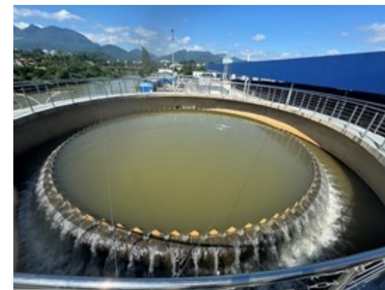
Pré-sedimentador remoção de areia após captação
